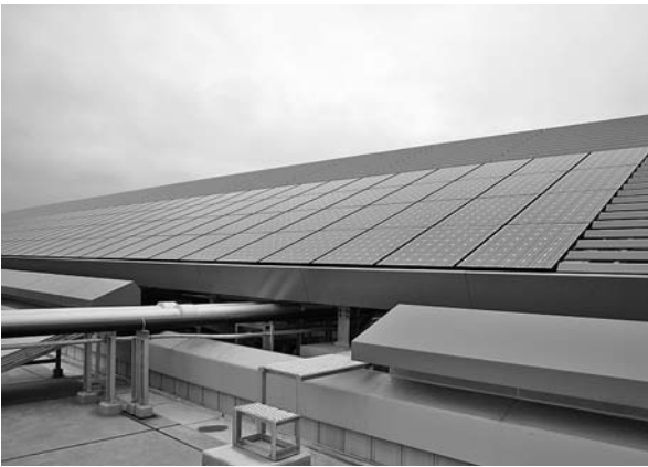
屋上に設置された太陽光パネル
