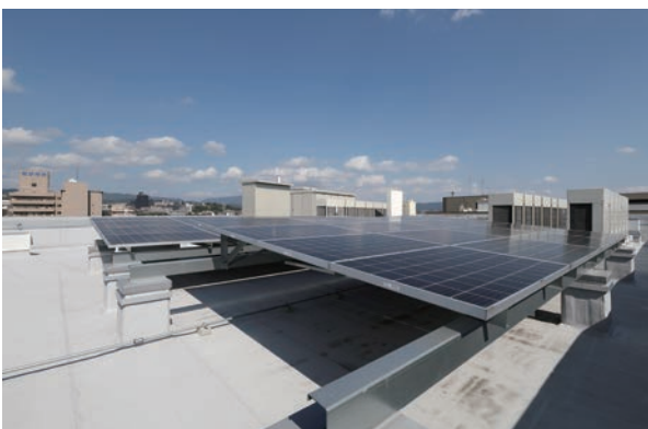
屋上に設置されたソーラーパネル
